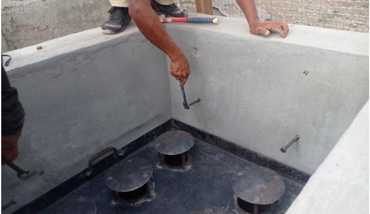
ပုံ (၁၅) - ကျပ်ခိုးစင်တန်းများ တင်သည့်နေရာ တပ်ဆင်ရန်အတွက် သံချောင်း (rebar) သို့မဟုတ် သံမူလီကို အသုံးပြုနိုင်ပါသည်။
